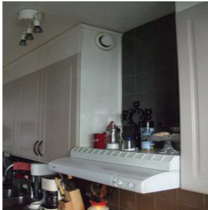
Kontrollventiler inom badrum och kök kan bibehållas.
